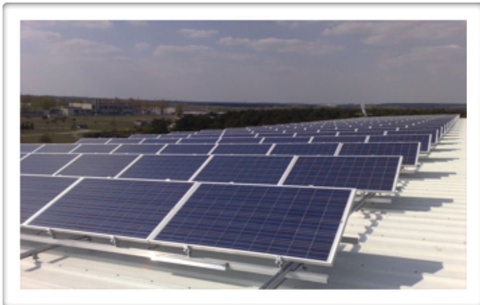
Solarzellen auf dem Kühlhausdach im Werk Bydgoszcz, Polen
